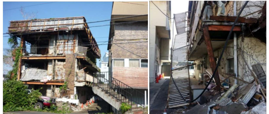
除却の行政代執行が行われたマンションの事例(滋賀県野洲市)
